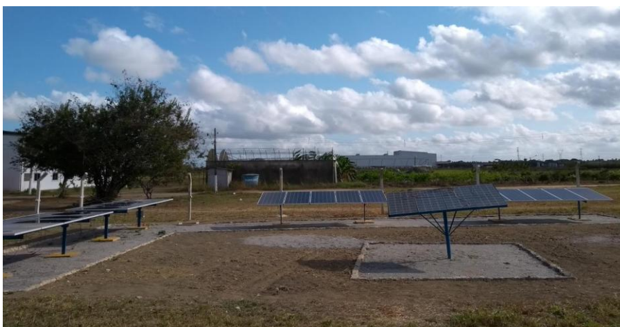
Fig. 1 - Sistema fotovoltaico montado em solo no Centro de Ciências Agrárias da Universidade Federal de Alagoas, situado na cidade de Rio Largo
